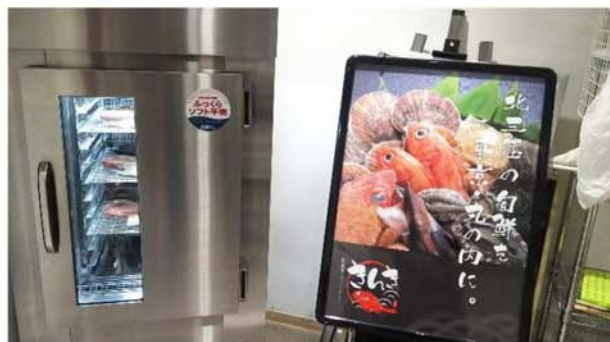
今回導入の干物製造機 KF-1000を厨房に設置
